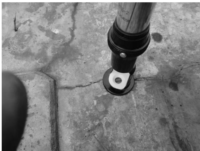
Рис. 11.13. Определение ширины раскрытия трещины при помощи мерного микроскопа МРБ-2
